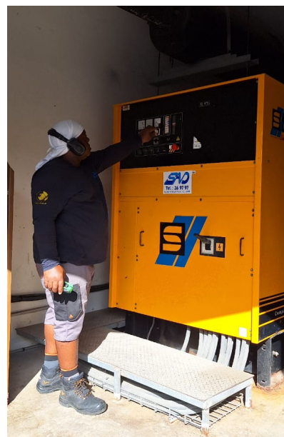
Groupe électrogène du bâtiment recherche
